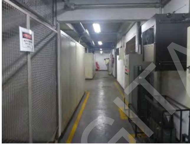
ASPECTO INTERNO – PISO G1 – ÁREA TÉCNICA
